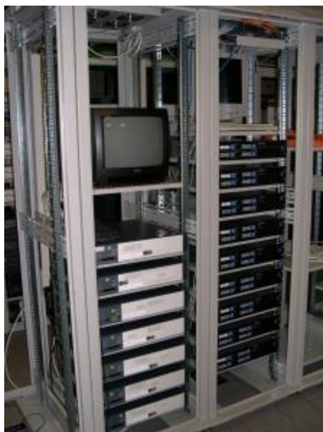
Une baie de serveurs
